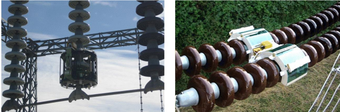
17. ábra Szigetelőrobotok működés közben [1]
